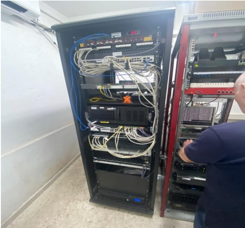
IT-Infrastruktur der Schule mit dem IT-Administrator Valero
